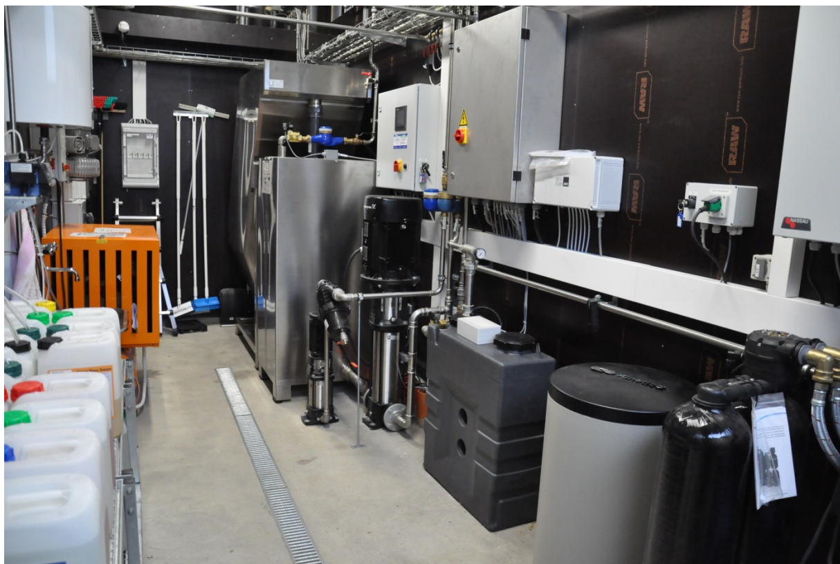
Fig. 2.2 Teknikrum med Bio Classic vandrensningsanlæg
