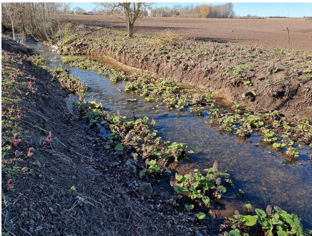
Tåstrup Å, projektstrækning, hvor der bl.a. er kraftigt nedskredne brinker.
