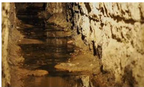
Gammel kloak der ikke er rottesikret
