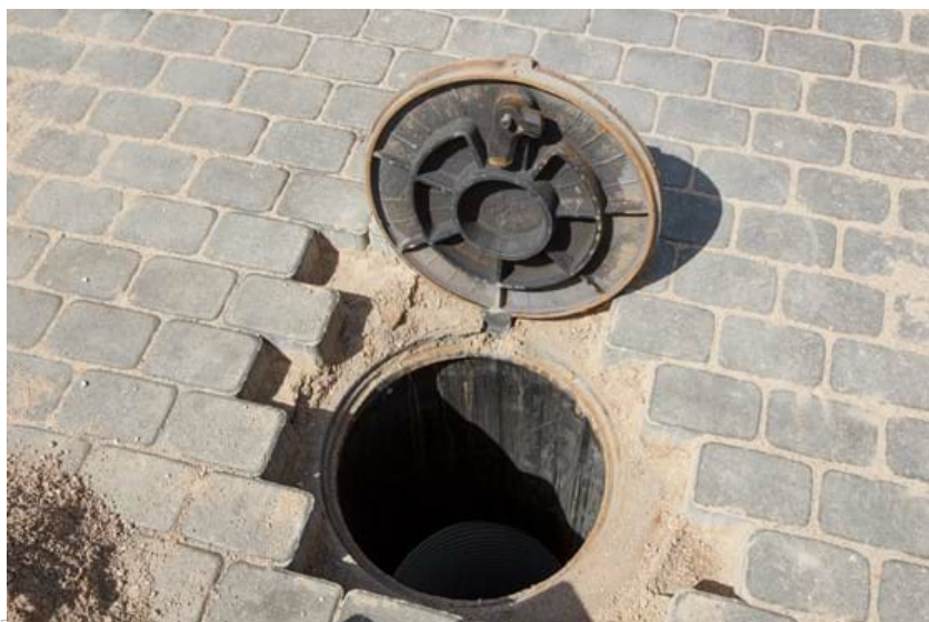
Foto af skelbrønd
