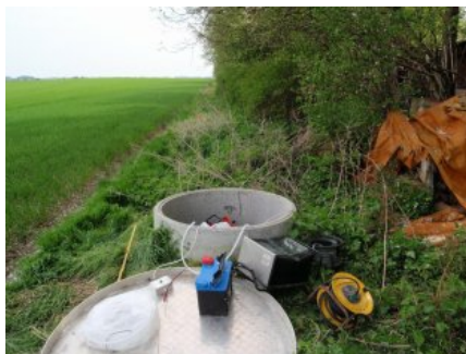
Overvågningsboringerne 198.707 og 198.708 (findes i samme brøndring)
